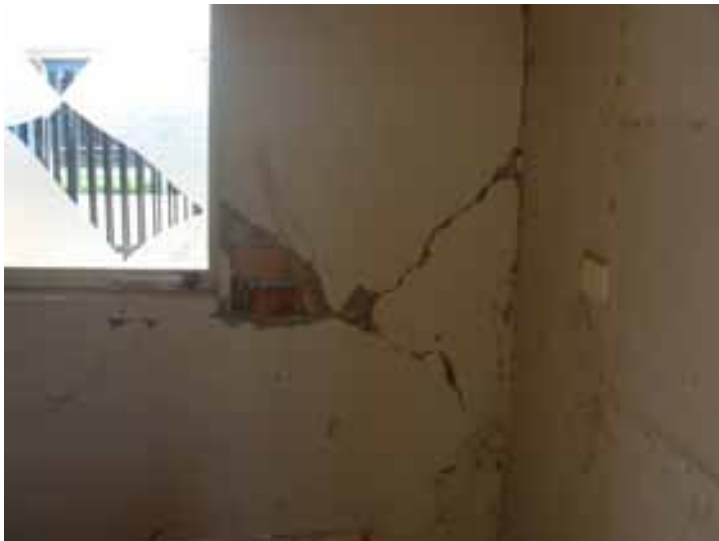
Figura 8: Se observa muro completamente agrietado y desprendido del muro lateral.
