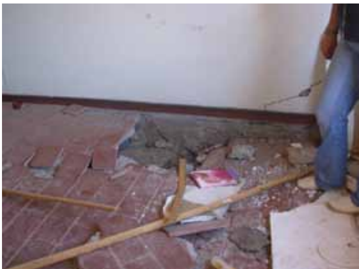
Figura 6: Se muestra asentamiento del suelo de aproximadamente 50 cm.
