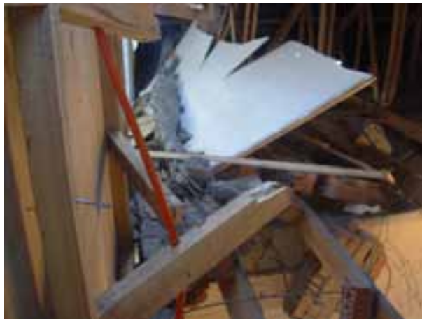
Figura 3: Se observa colapso de muro cortafuego
