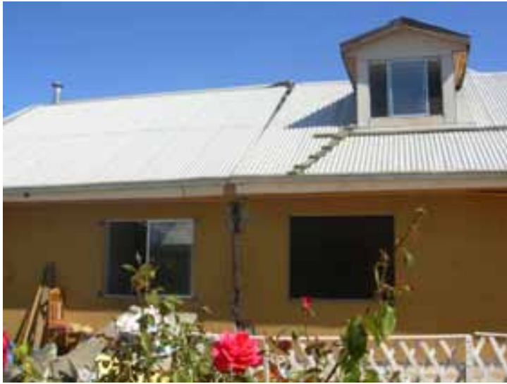
Figura 7: Se muestra daños estructurales en muro divisorio y grietas horizontales.
