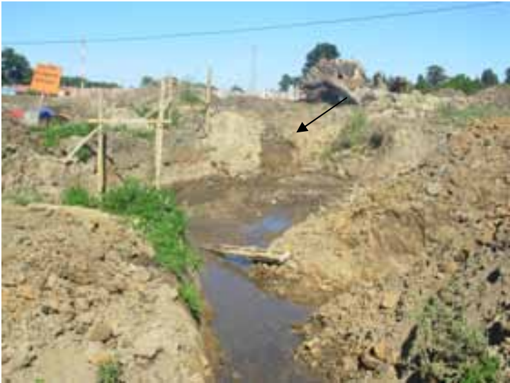
Figura 10: En excavaciones en terrenos colindantes, la flecha indica sector donde se observa escurrimiento de aguas subterráneas, hacia los terrenos de la Villa Galilea.
