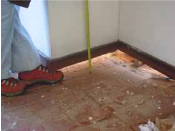
Figura 5: Se muestra asentamiento del suelo, donde los muros de tabiques quedan desprendidos del suelo, colgando del techo.
