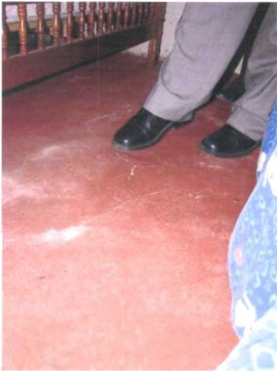
Grietas en radior
