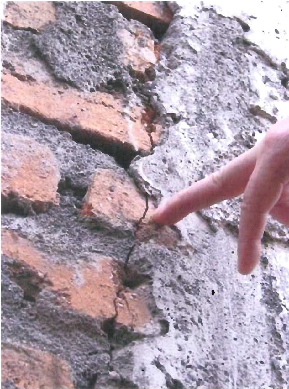
Grieta que muestra quiebre en los ladrillos, también se aprecia en el interior
