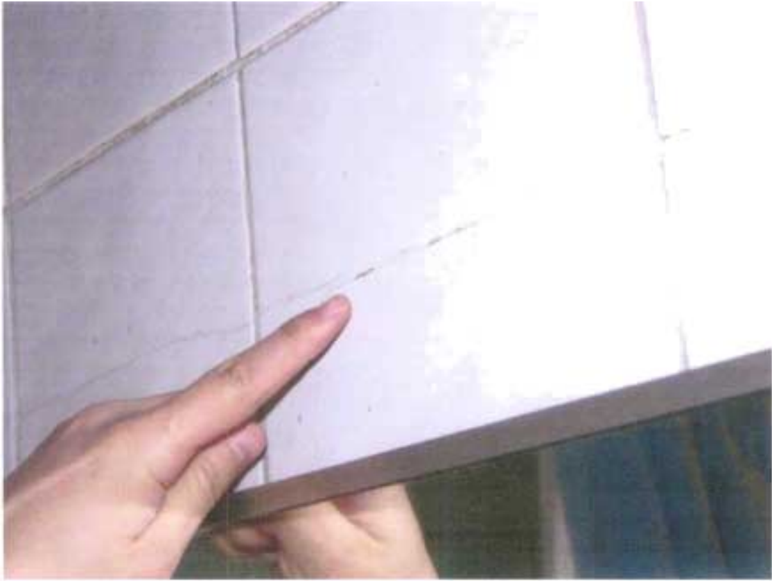
Grieta horizontal en cerámica de baño
