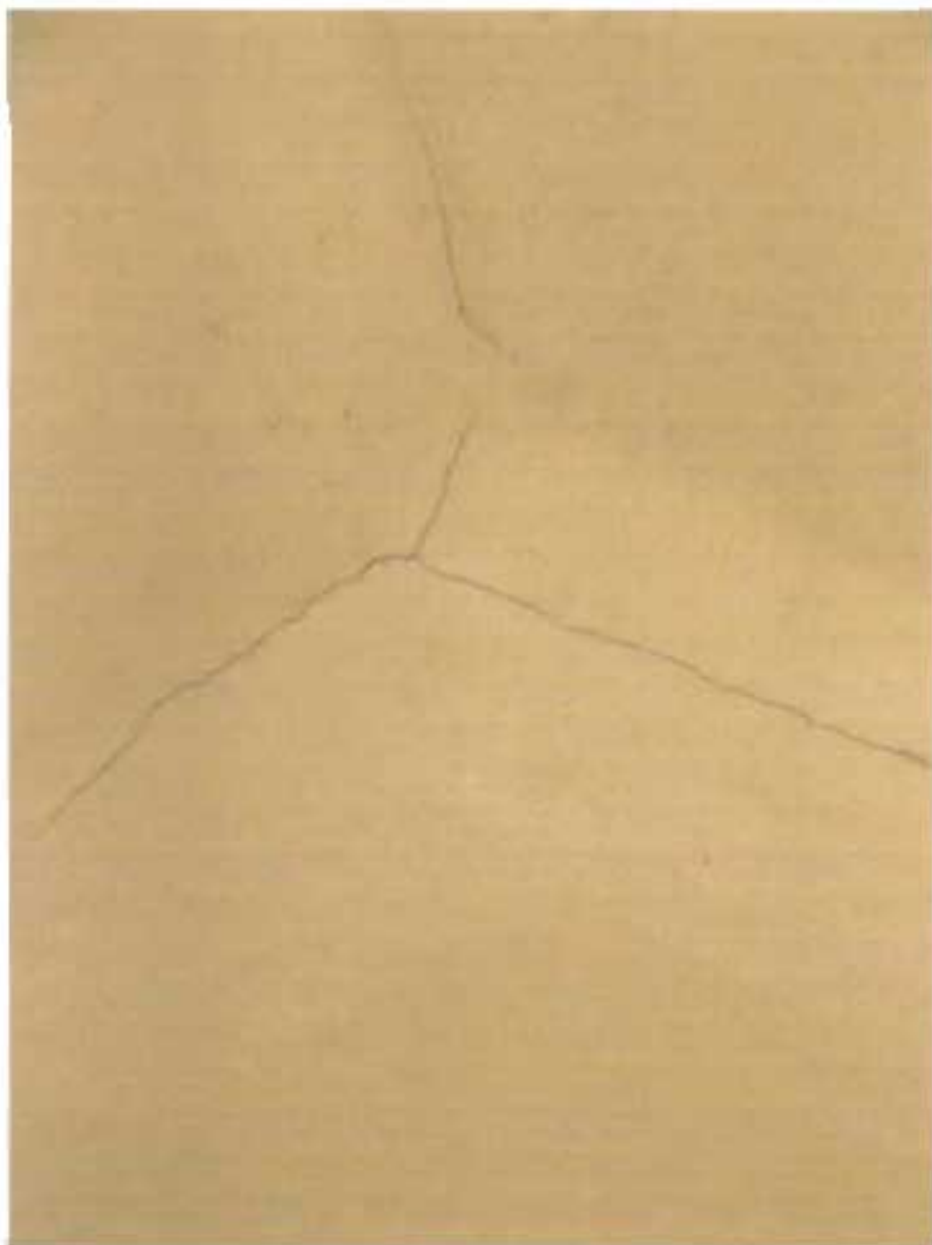
Grietas en juntas de techo
