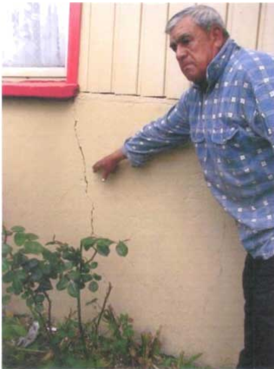
Grieta vertical en pared exterior, la que también se aprecia en el interior (dormitorio)
