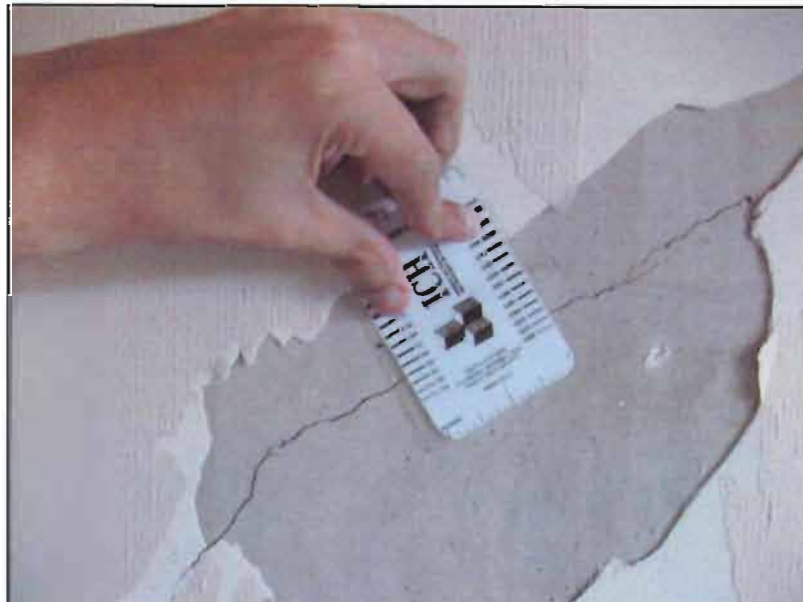
Fisura por corte de 0,5mm de espesor en muro de hormigón armado.
