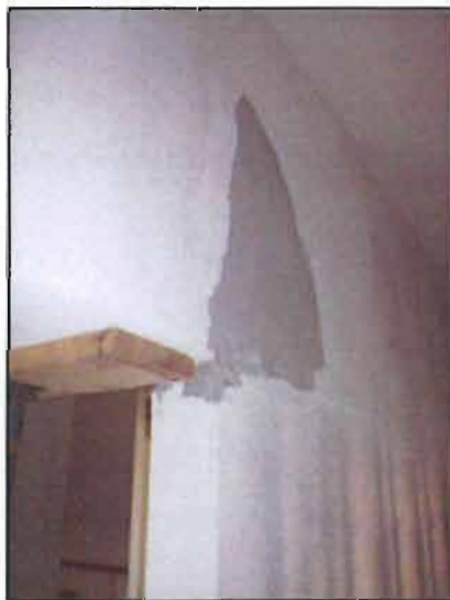
Desprendimiento de revestimiento
