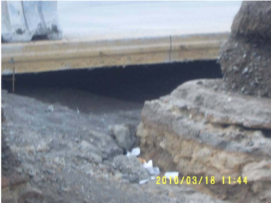
Socavación Kilometro 1+600 al 1+610
