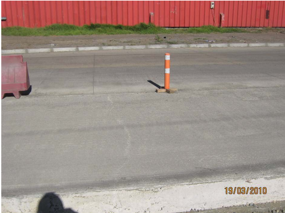
Pavimento fisurado Km. 2365
