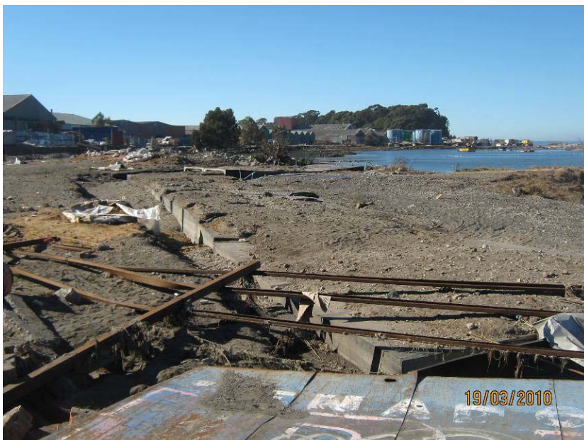
Colector 190 con cajones de H.A. desnivelados
