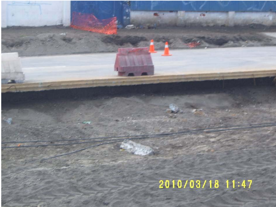
Socavamiento Desde Km. 1652 al Km. 1695
