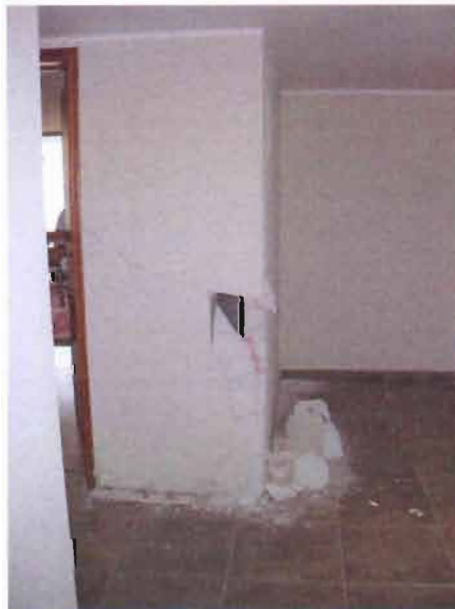
Fotografía2: Falla tabique no estructural
