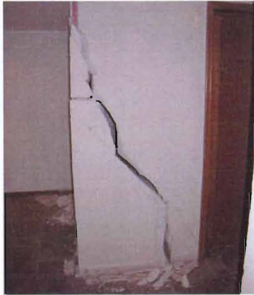
Fotografía1: Falla tabique no estructural
